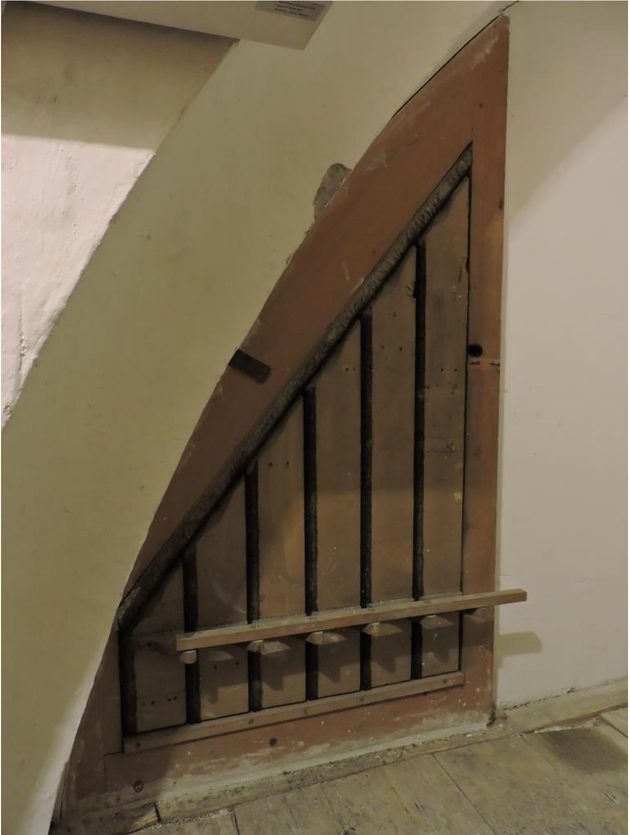
Abb. 81: Baden AG (Opus 440, 1914/1915), die Reste der Fernstation, von innen gesehen, Zustand 2018 (Bernhard Hörler).
